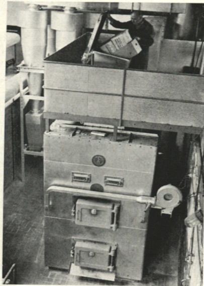
Abb. 5: Müllverbrennungs-Schacht-ofen (im Hintergrund: Zyklon-Entstauber) Dr. Schmitz & Apelt GmbH, Wuppertal
