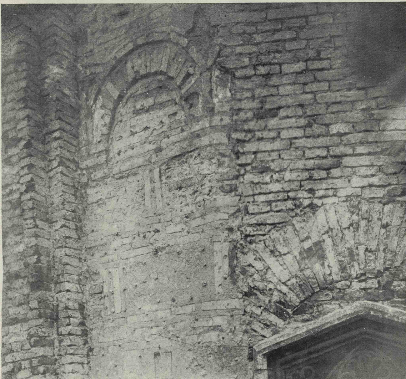
Fig. 83. — Biserica Curtea Veche din București. Detaliu de zidărie înainte de restaurare.
