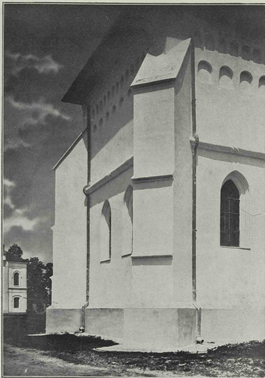
Fig. 108. Episcopia Romanului. Contraforturile pridvorului. (C.)
